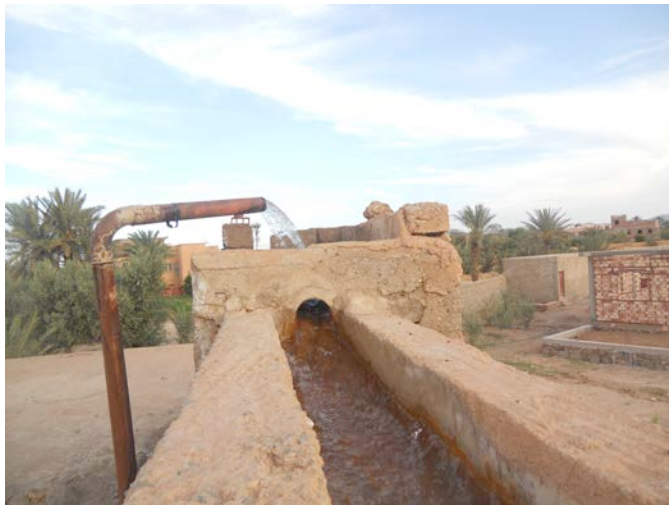
Figure 3 Station de pompage individuelle à Tlout, Tinghir (Photo Mahadne, 2012)
